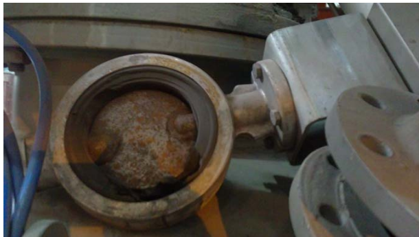
Фото 3. Вентиляционный поворотный клапан ПКН на комплексных испытаниях блока 225 МВт на Черепетской ГРЭС.
