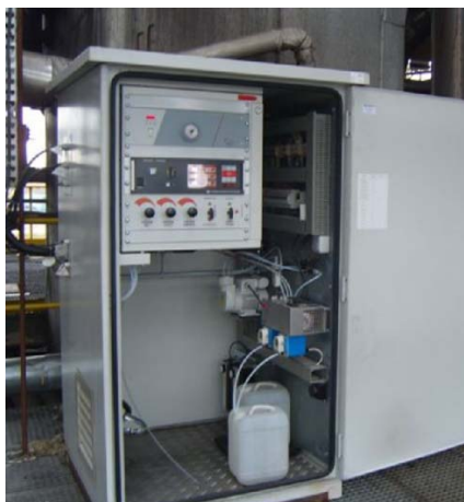
Рис. 4. Система пробоподготовки и анализатор в шкафу.
