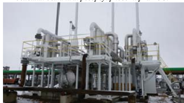
Рис.9. ККР 1200, производительность 1200 м 3 /час. Фанипольская нефтебаза, компания РУП «Белорусьнефть-Минскоблнефтепродукт». Одновременная и независимая рекуперация паров автомобильных бензинов при больших и малых дыханиях двух резервуарных парков и при работе АСН в автоцистерны (11 стояков налива).
