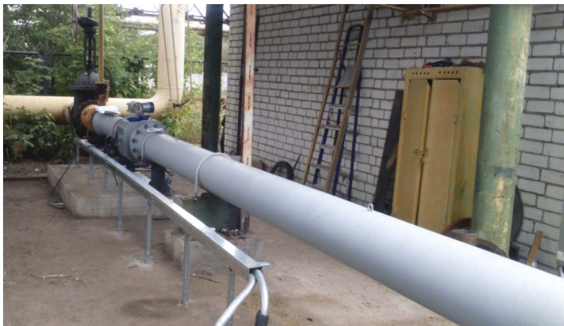
Рис. 6. ALTOSONIC V12 ДУ 300 на узле учета природного газа на Выксунском металлургическом заводе.
