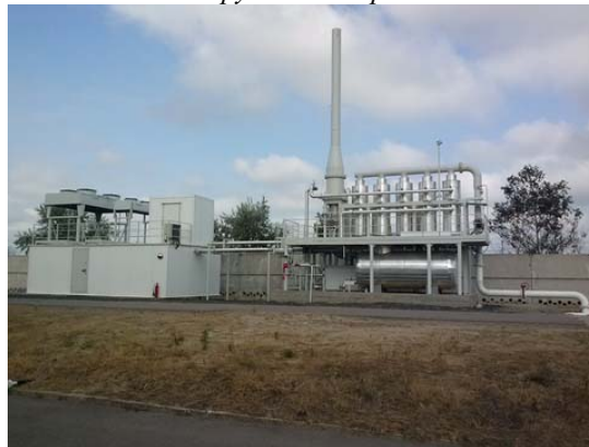
Рис.4. ККР 1000, производительность 1000 м 3 /час. Терминал нефтепродуктов ЗАО «Азовпродукт». Рекуперация паров автомобильных и прямогонного бензина при больших и малых дыханиях резервуарного парка и при загрузке танкера.
