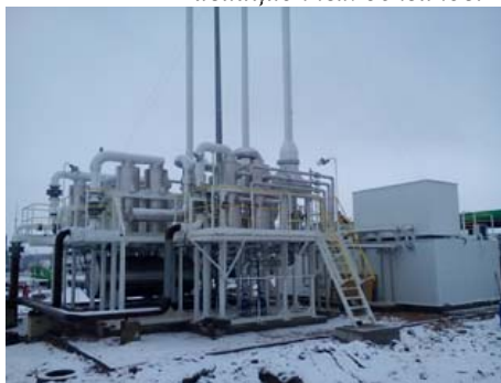
Рис.10. ККР 1200, производительность 1200 м 3 /час. Фанипольская нефтебаза, компания РУП «Белорусьнефть-Минскоблнефтепродукт». Одновременная и независимая рекуперация паров автомобильных бензинов при больших и малых дыханиях двух резервуарных парков и при работе АСН в автоцистерны (11 стояков налива).
