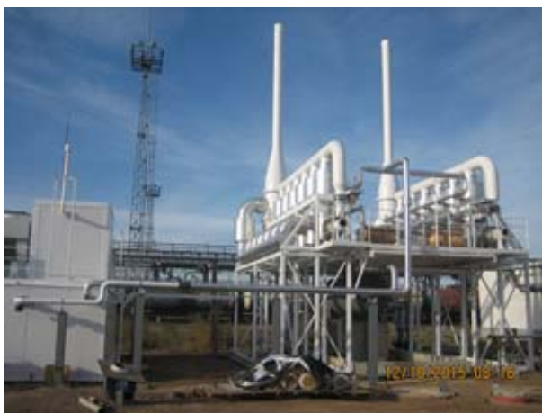
Рис.6. ККР 5000, производительность 5000 м 3 /час. Производство по транспортировке и хранению нефтепродуктов ООО «ЛУКОЙЛ- Волгограднефтепереработка». Рекуперация паров светлых нефтепродуктов от ж/д эстакады №4.
