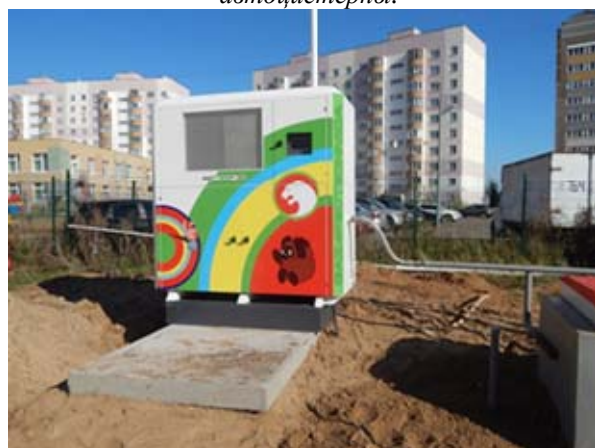
Рис.7. ККР 30М, производительность 30 м 3 /час. Казань, АЗС группы компаний «Транзит Сити». Рекуперация паров автомобильных бензинов при больших дыханиях резервуарного парка АЗС.
