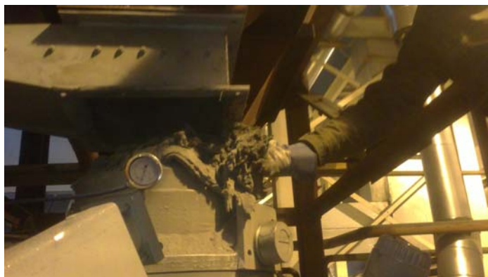
Фото 7. Очистка системы шлакоудаления от комьев мазута перемешанного со шлаком–на исправность клапана работа на данном материале не повлияла.
